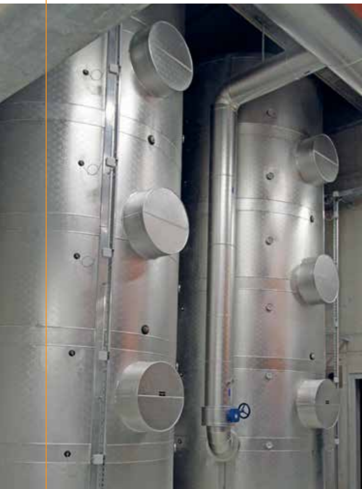
Accumuli da 30 m 3 ciascuno
