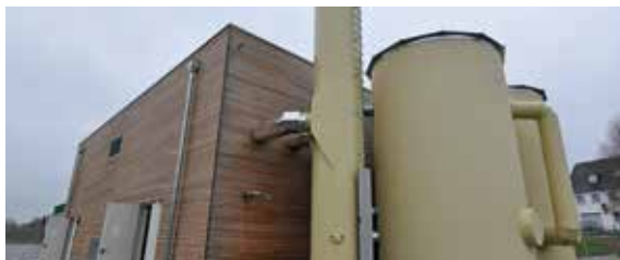
La centrale termica con i due accumulatori puffer da 60'000 litri ciascuno è ubicata esattamente tra i due villaggi di Neuerkirch e Külz.
